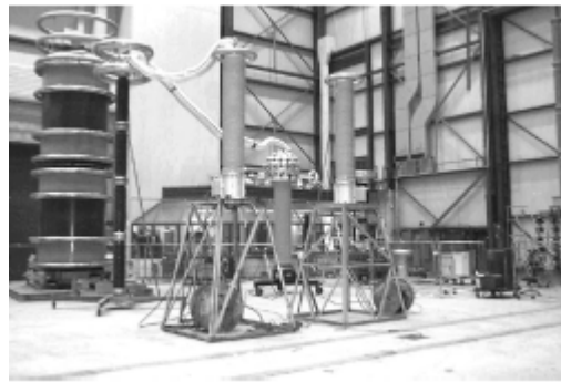
شکل ۳: مجموعه تست فشار قوی برای OVT ۲۳۰ کیلو ولت
